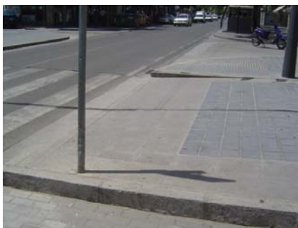
Vado peatonal sin señalización para invidentes (Montilla)
