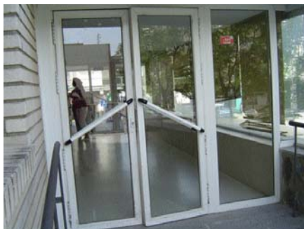
Puertas sin señalización (Montilla)
